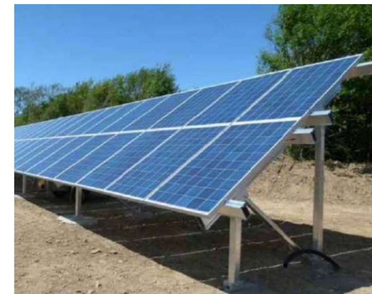
Figure 3 – Modules photovoltaïques (hauteur 2,2m par rapport au sol)
